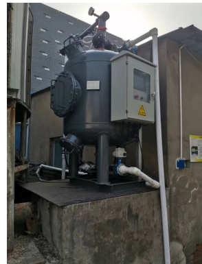
过滤净化装置——浅层介质过滤器
